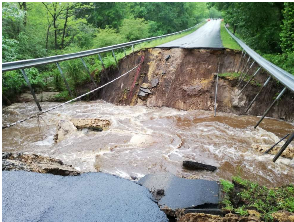
Pont détruit par la Petite Leyre à Sore (40). Photo Pascal Bats pour Sud-Ouest
